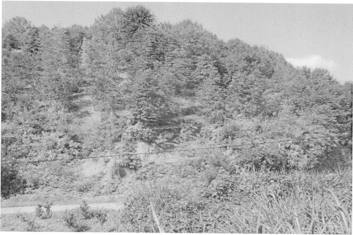
(一) K7+080 处 B102 崩塌
