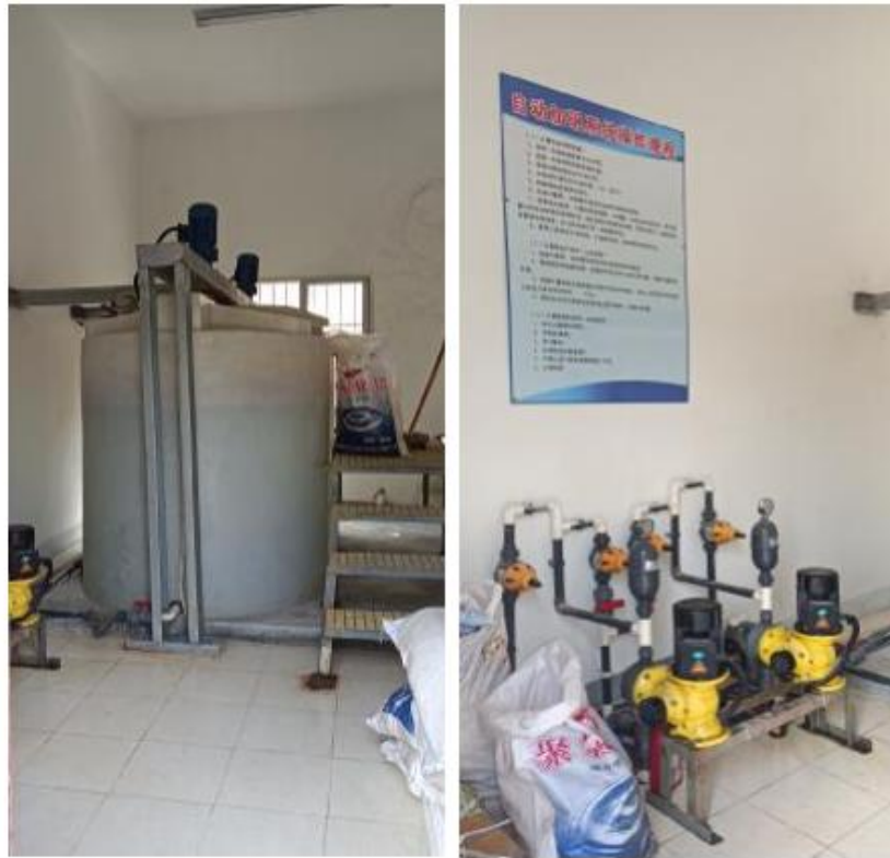
图 4.12-1 生活水厂现状加药间
