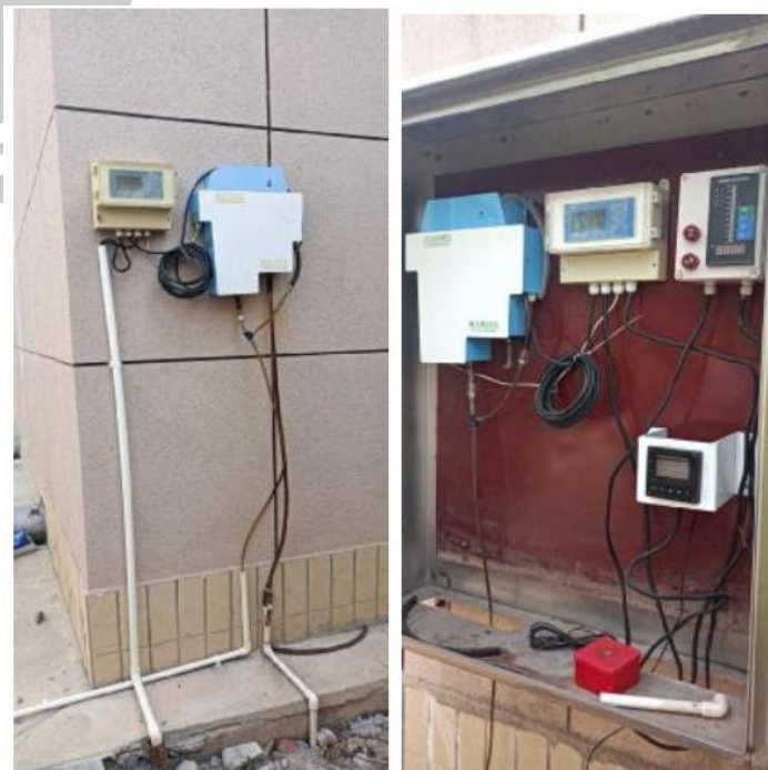
图 4.12-5 生活水厂现状水质监测设备
