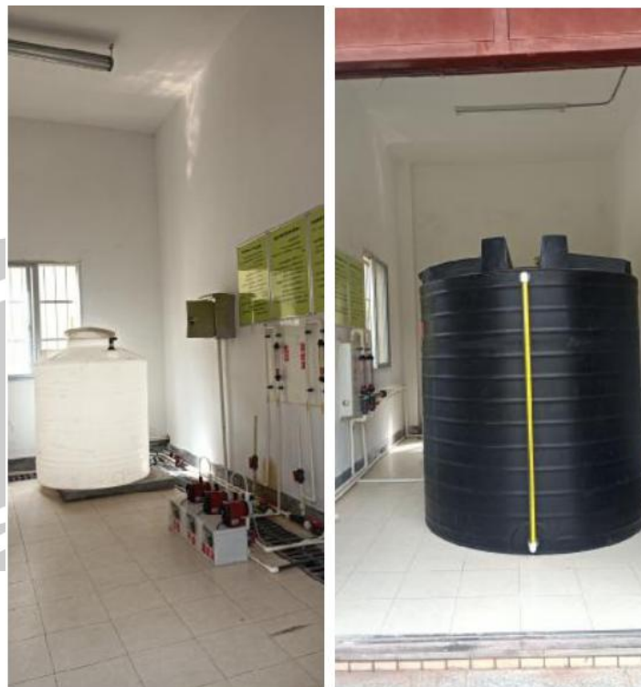
图 4.12-3 生活水厂加氯储氯间
