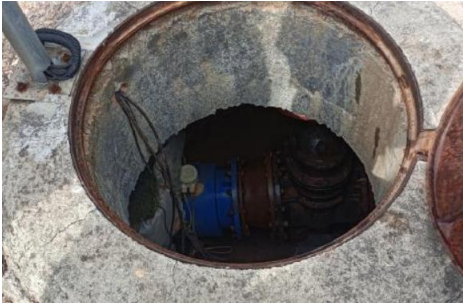
图 4.12-6 生活水厂现状流量计井
