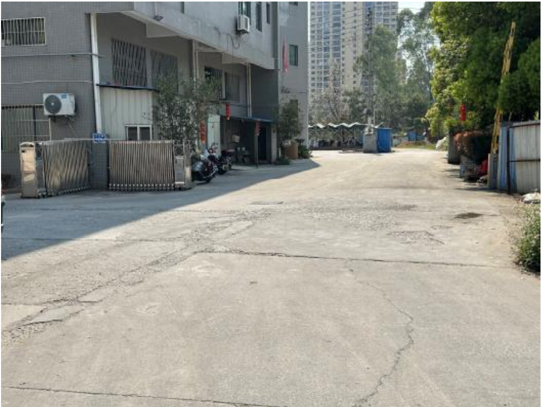
道路现状破损路面
