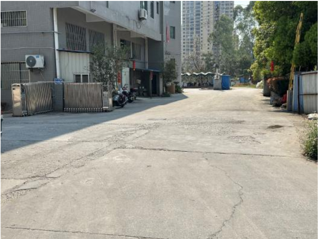
道路现状破损路面
